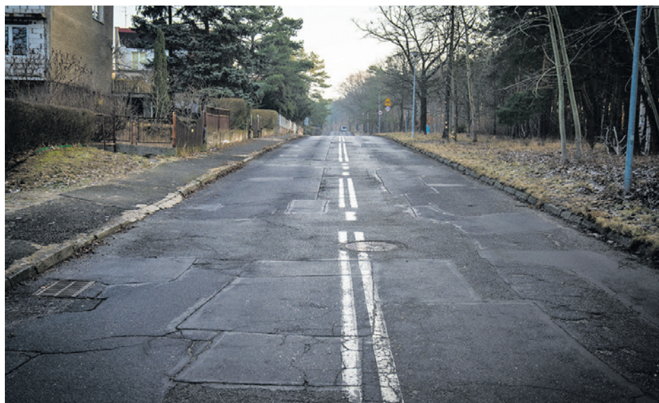
O remont ulicy Jagodowej od lata prosili mieszkańcy. Dziurawa jezdnia i rozsypujące się chodniki wkrótce przejdą do historii.
